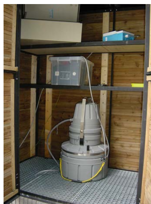
Photo 4 – Exemple de préleveur automatique
